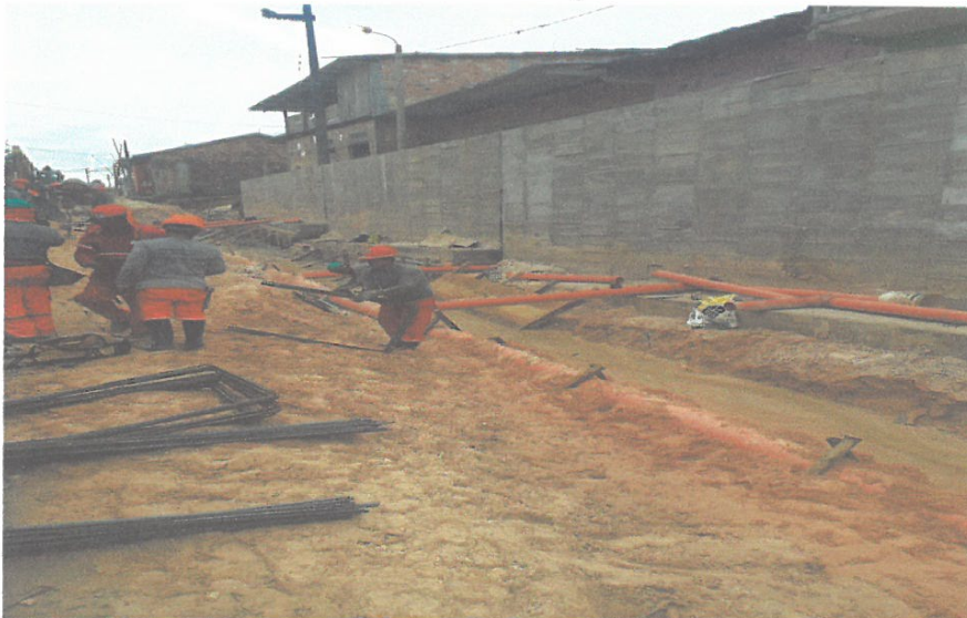
Instalaciones Sanitarias Jr. Itaya.
