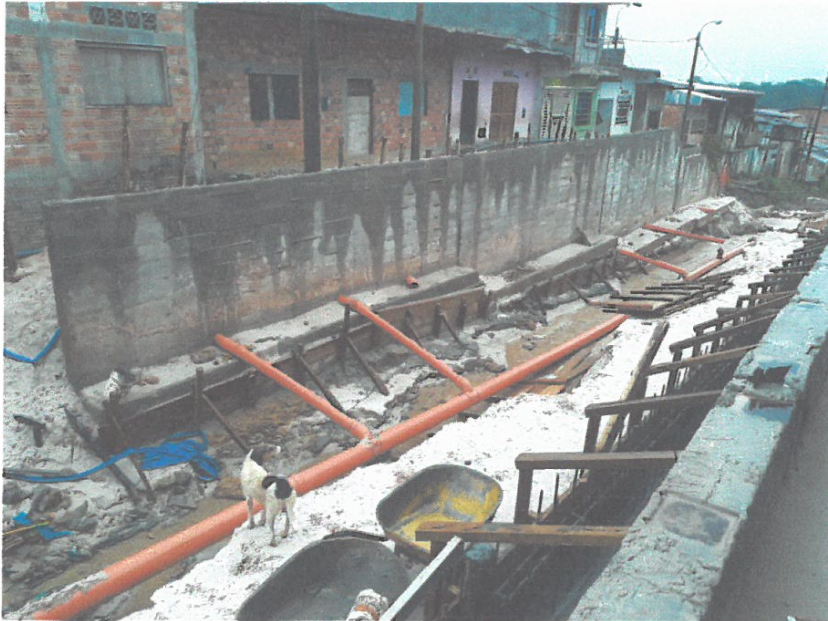
Instalaciones Sanitarias Jr. Itaya
